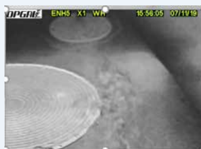
废水处理池密封井盖泄漏
