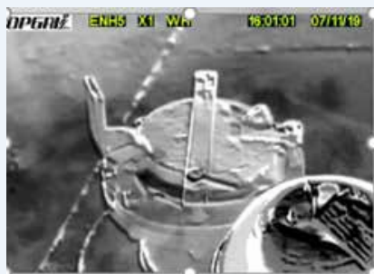
储罐顶部泄压阀泄漏
