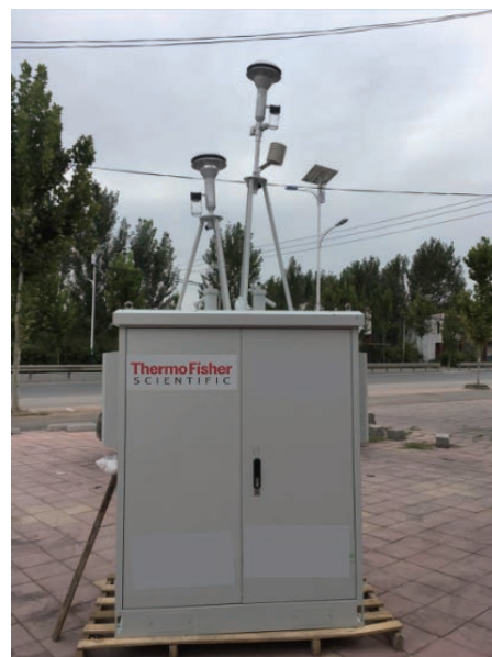
5028i 安装于环境控制机柜中
